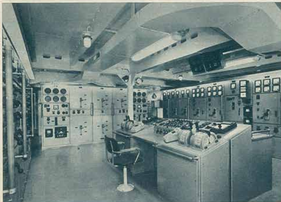
TARMOn tauluhuone, diesel-sähköisen voimansiirtojärjestelmän hermokeskus. Potkurimootoreita voidaan ohjata paitsi tauluhuoneesta myös suoraan komentosillalta ja ohjaamosta.
